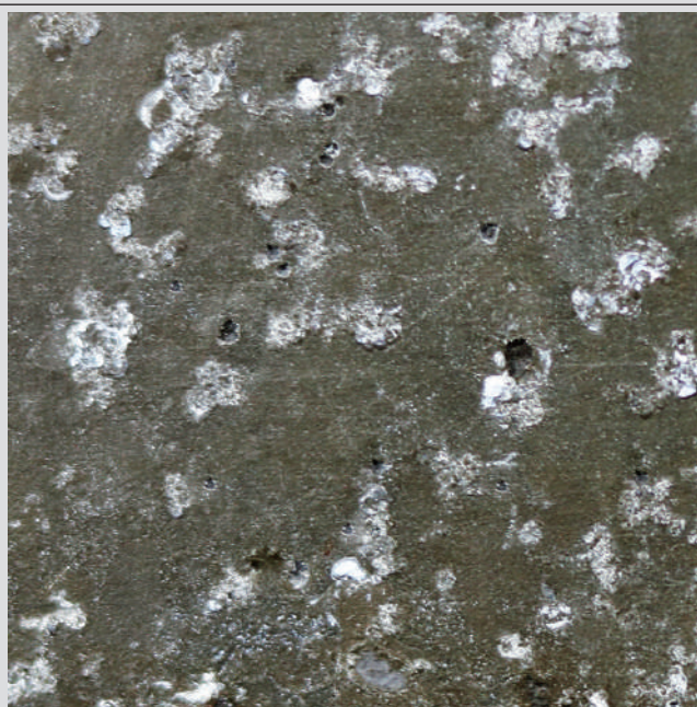
Dettagli sulla corrosione superficiale
